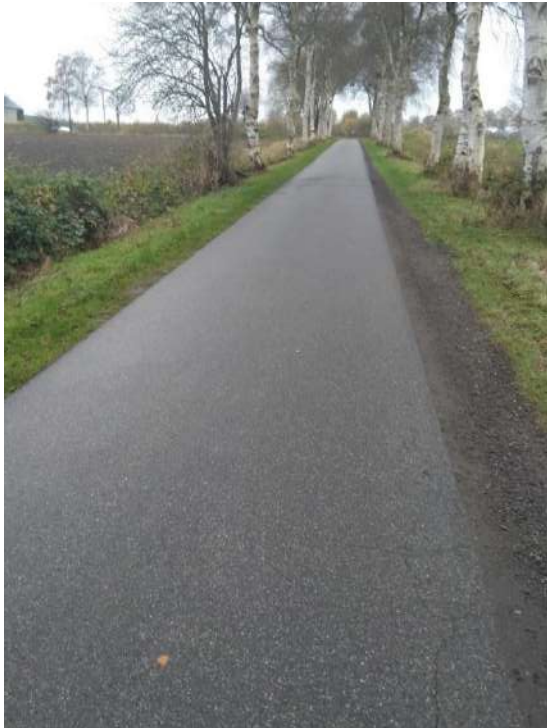
Abbildung 54: Schmalere Wirtschaftsweg in gutem Zustand
