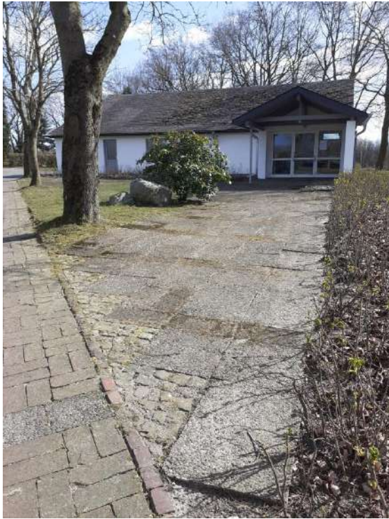
Zugang zur Kapelle mit Betonpflastersteinen ... inklusive unfallgefährdender Verwerfungen.
