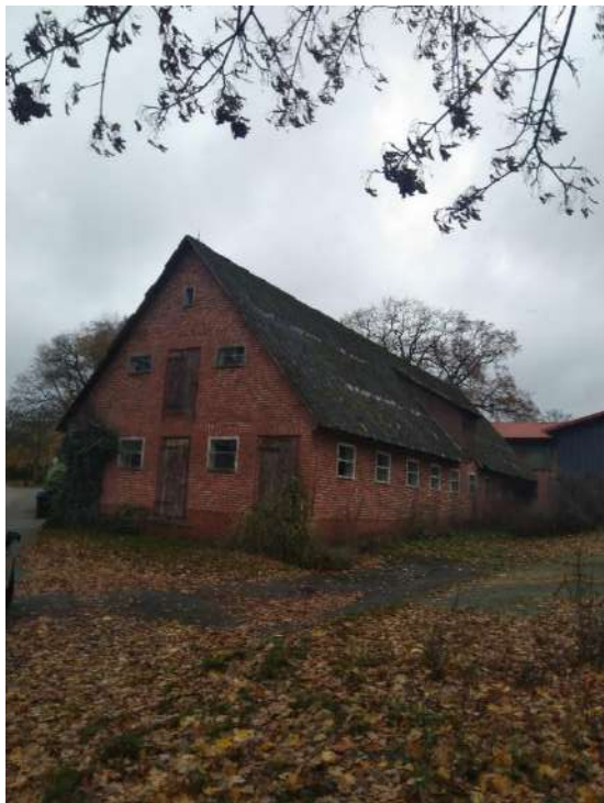
Abbildung 58: Noch sind es eher kleinere Gebäude, die kaum noch eine sinnvolle Nutzung zulassen!
