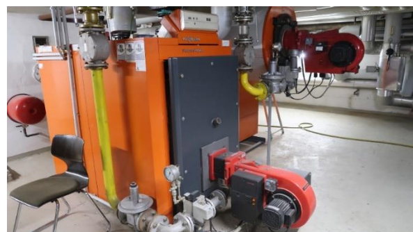
Abbildung 11: Gaskessel im Heizungskeller (Eigene Darstellung)
