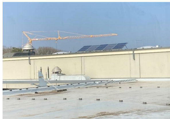
Abbildung 12: Kleine PV-Anlage auf dem Dach der Selma-Lagerlöf-Oberschule (Eigene Darstellung)
